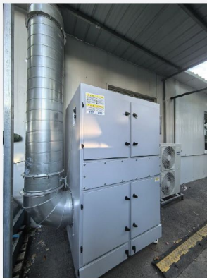
粉尘废气收集处理装置
