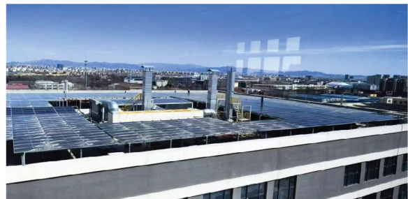
公司屋顶的太阳能光伏发电装置
